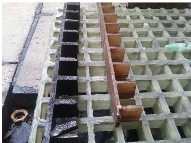
图 3-2 格栅板腐蚀性情况对比
