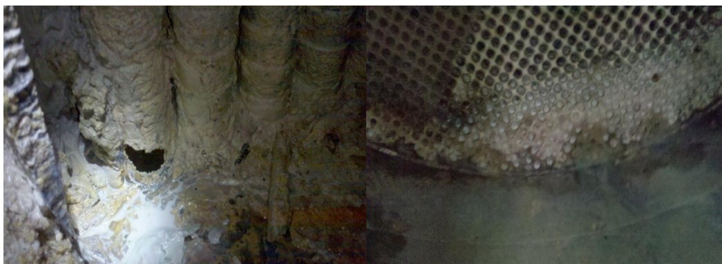
图2 热交换器内部腐蚀情况
