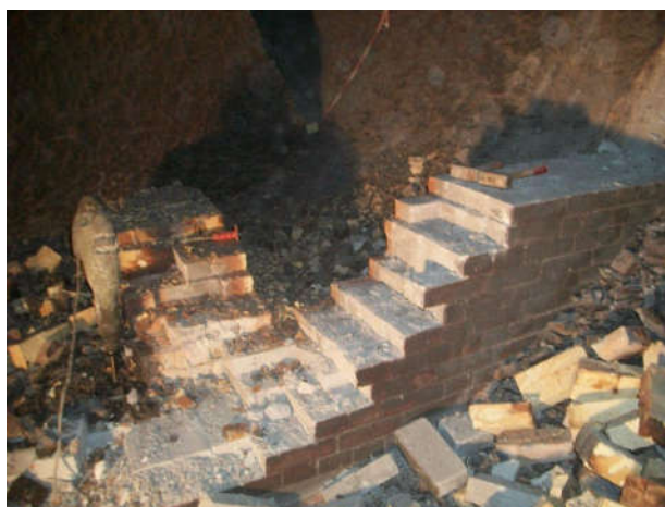
图 5 坍塌的挡墙，采用了传统砖块和耐火泥
